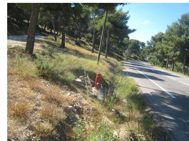
Borne incendie le long de la RD9d – EGIS France
