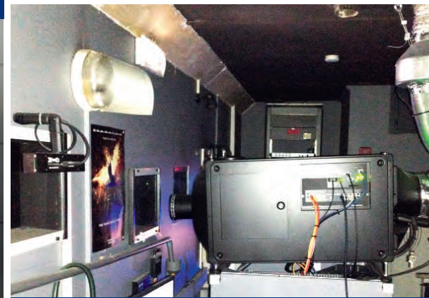
À Saint-Rémy-de-Provence, un nouveau projecteur laser a été installé.
