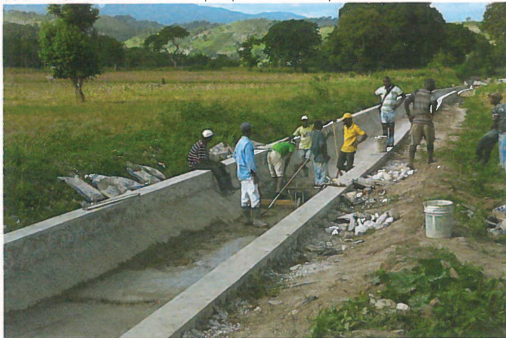
Travaux de réhabilitation sur le canal principal Laborde dans le périmètre d'Avezac en Haïti
