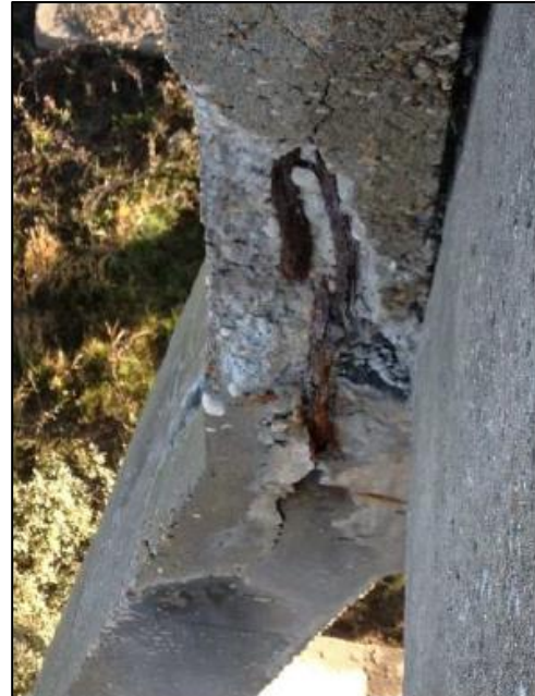
Photo n°6 : Armatures apparentes (cadres) et épaufrure pluri-décimétrique à la liaison poteau / chevêtre
