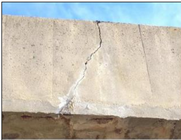
Photo n°1 : Fissure d'effort tranchant traversante sur bajoyer
