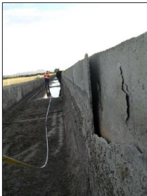
Photo n°3 : Décollement d'enduit et épaufrures en bajoyer
