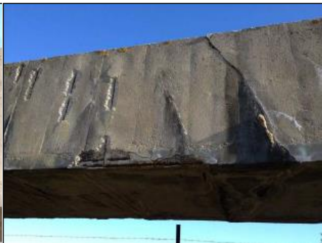
Photo n°2 : Fissure suintante sur bajoyer avec épaufrures et armatures apparentes
