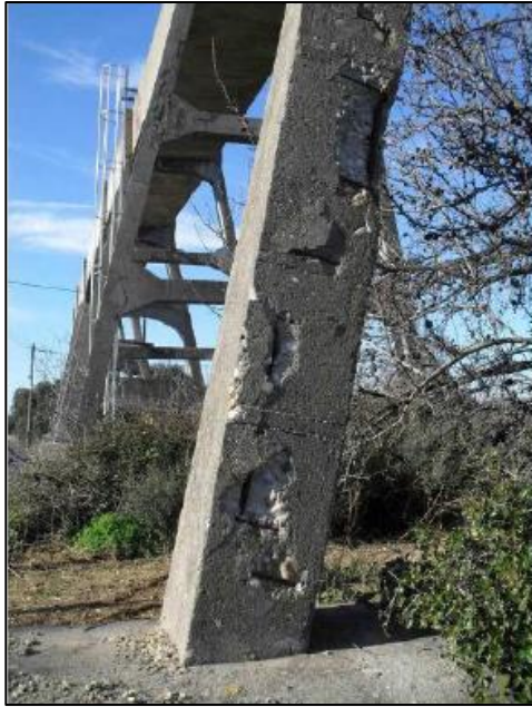
Photo n°5 : Armatures apparentes (cadres) et épaufrures pluri-décimétriques
