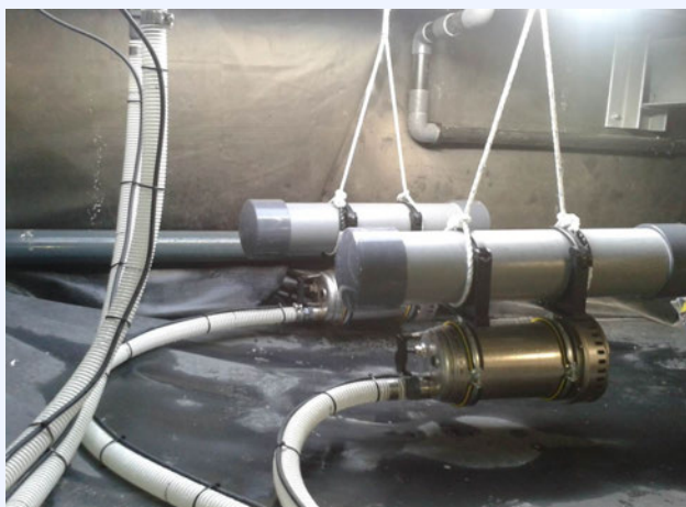
Vue des pompes Drenag et flotteurs
